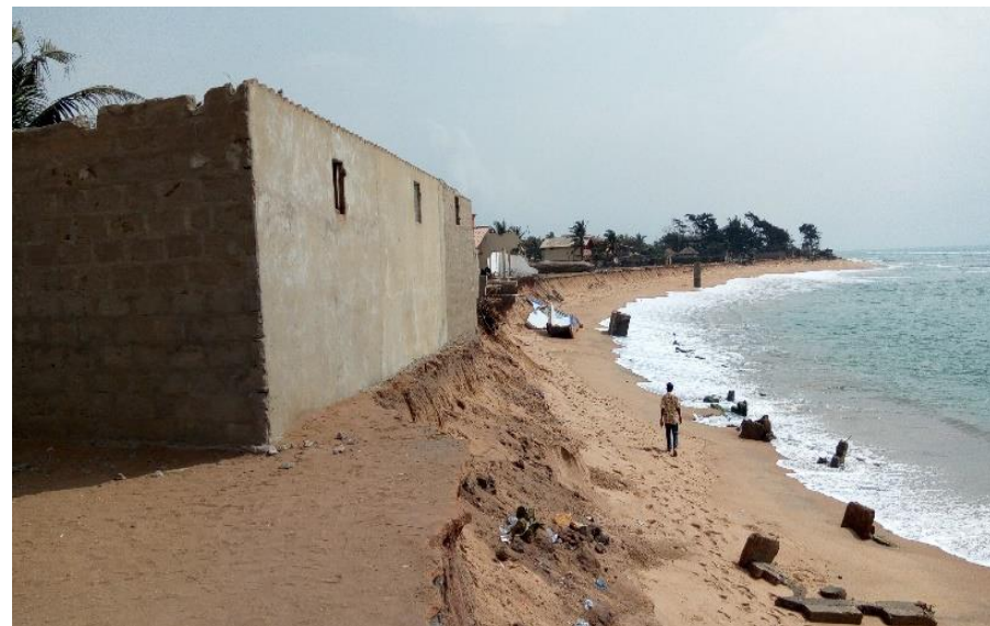
Photo 3 : bâtiment se retrouvant sur le trait de côte à cause de l'érosion
