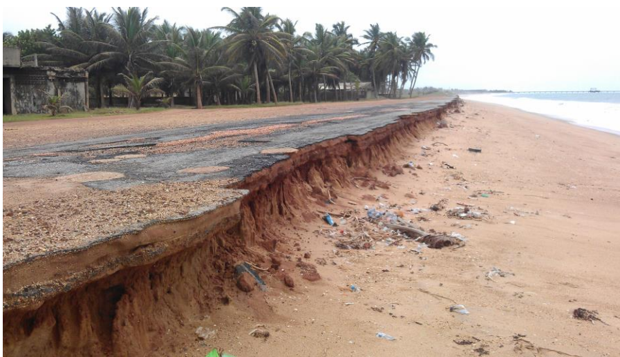
Photo 2 : ancienne route côtière érodée
